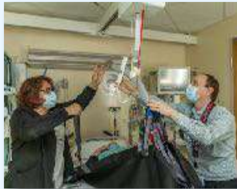
L'IA Annette Landry et le Dr Brian Moses font une démonstration d'un nouveau lève-personne fixé au plafond dans l'USI
